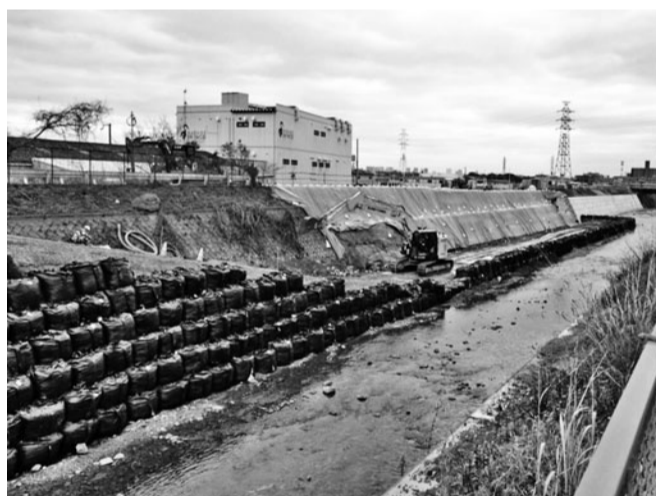
間知ブロック積み護岸から大型ブロック積み護岸に改修する
